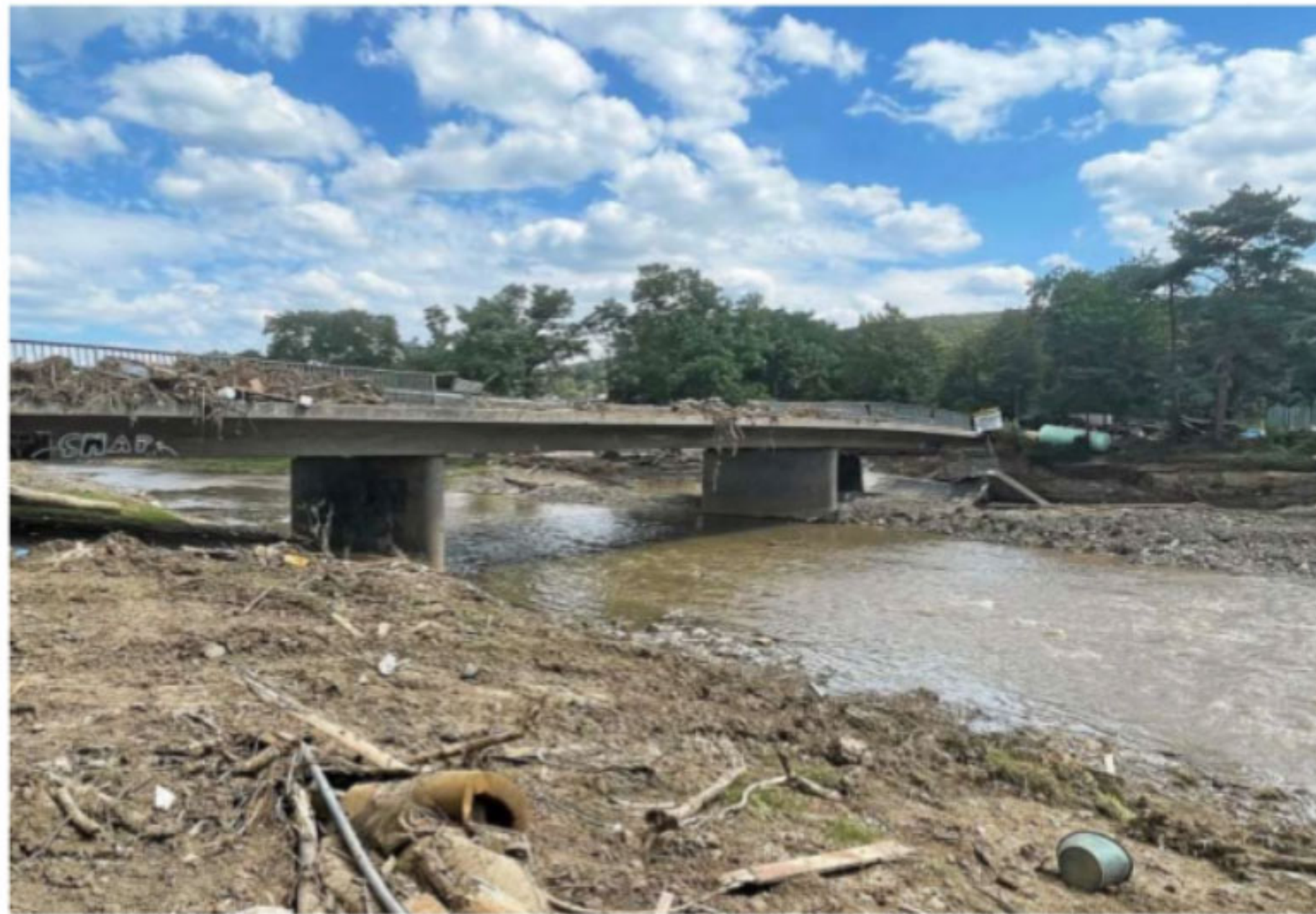
Die Ahr hat sich nach dem Hochwasser wieder in ihr Flussbett zurückgezogen. Diese Brücke bei Bad Neuenahr ist von den Fluten stark zerstört worden. FOTO: CHRISTOPH MUHL
